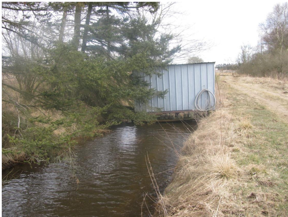
Figur 2.3.3: Skur med kalkdoseringsenhed placeret over fødekanalen ca. 50 m nedstrøms stemmeværket. Foto 12. marts 2013.
