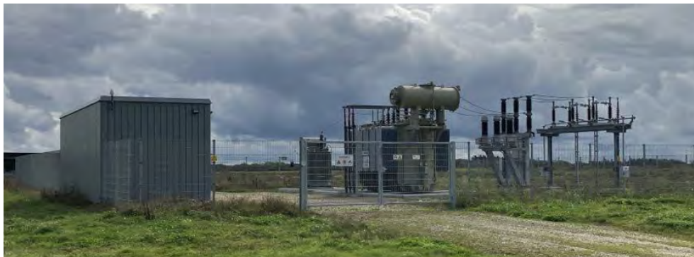
Figur 1-5 Eksempel på transformere og teknikbygning.
