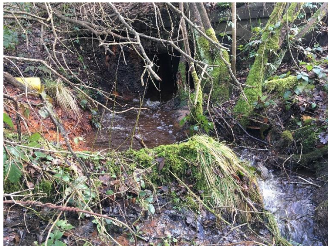
Figur 3-3. Vandløbsbunden hæves ved udlægning af sten/grus neden for to rørbroer, her den gl. jernbanebro i bækkens station 3.347.
