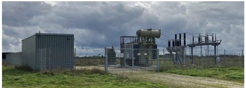
Figur 1-5 Eksempel på transformer og teknikbygning.
