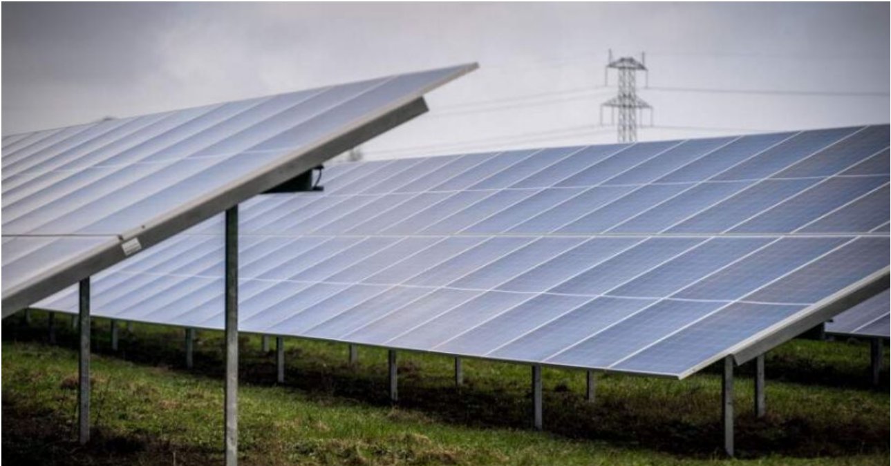
Figur 1 Solcellepaneler på faste stativer
